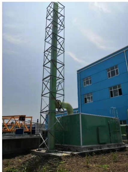
生物除臭装置
